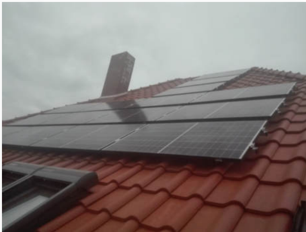
6,8 kWp Hausprojekt Wohnen & Wirken (MD)
