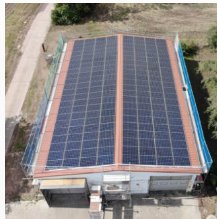
56 kWp landwirtschaftliche Lagerhalle Wanzleben-Börde
