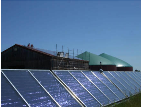
16,67 kWp Stadtwerke Wanzleben
